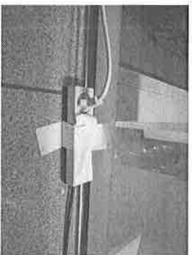
Slika 7. Položeni nezaštićeni produžni kabel
