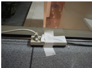
Slika 7. Položeni nezaštićeni produžni kabel
